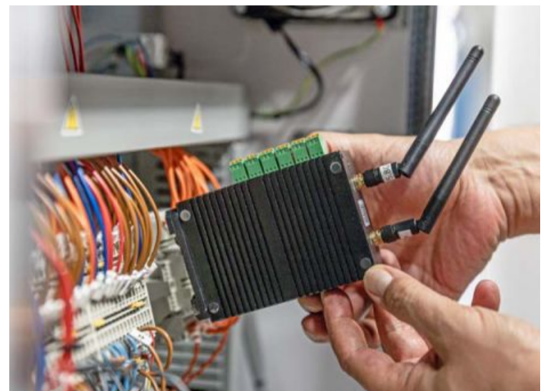
Die Hardware, die hier gerade installiert wird, überträgt Anlagedaten in die Cloud. MUV digital verspricht eine kostengünstige Lösung, die binnen weniger Minuten installiert ist und sich unkompliziert bedienen lässt.
